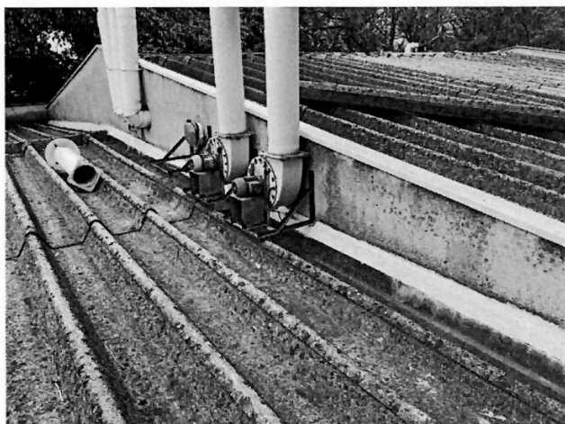
Figura 6. Exaustões em Oitão Bloco H.
