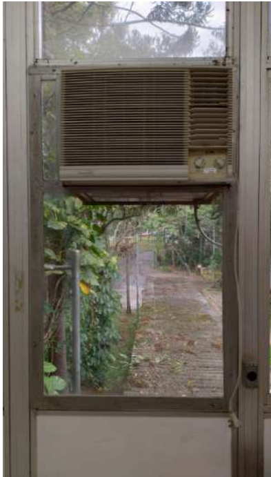
Foto 1: Exemplo de condicionador de ar de janela instalado hoje no Instituto.
