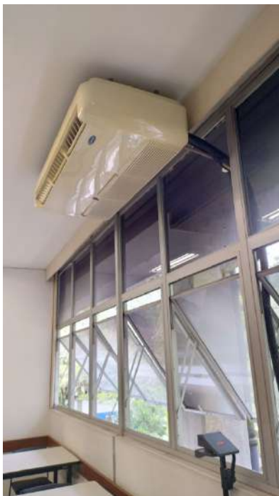
Foto 2: Exemplo de condicionador de ar split instalado hoje no Instituto.
